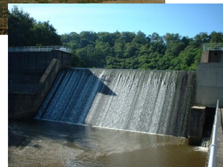
Barrage de retenue
